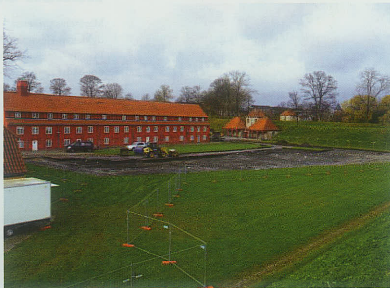
Entreprenørmaskinerne er begyndt at klargøre til byggeriet af Det Nationale Monument på Kastellet.
