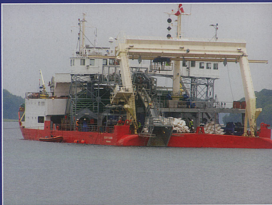
Kabelskibet "Henry P. Ladin" på arbejde i Fænøsund. (Kilde og foto: Carl Christian Vittrup)
