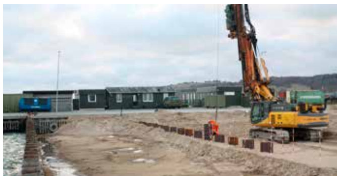
▲ Opfyldning af den inddæmmede del af havnen på Flådestation Frederikshavn er nu så fremskredet, at der kan arbejdes med den indre spunsvæg. Væggen skal virke som anker for den ydre og modvirke, at den kan skride ud ved belastning.
